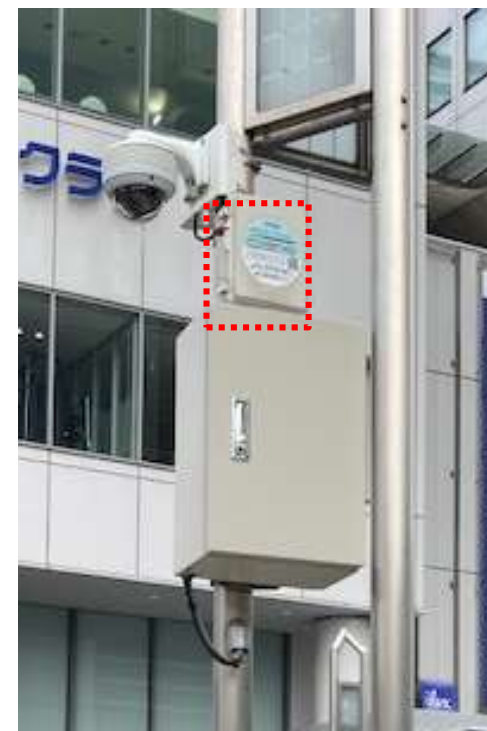
センサーの設置例 (喜多町2丁目)
